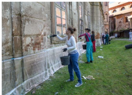
↑ Vlhčení podkladu před nanášením odsolovacích omítek v rámci letní školy práce s vápnem v Plasích
