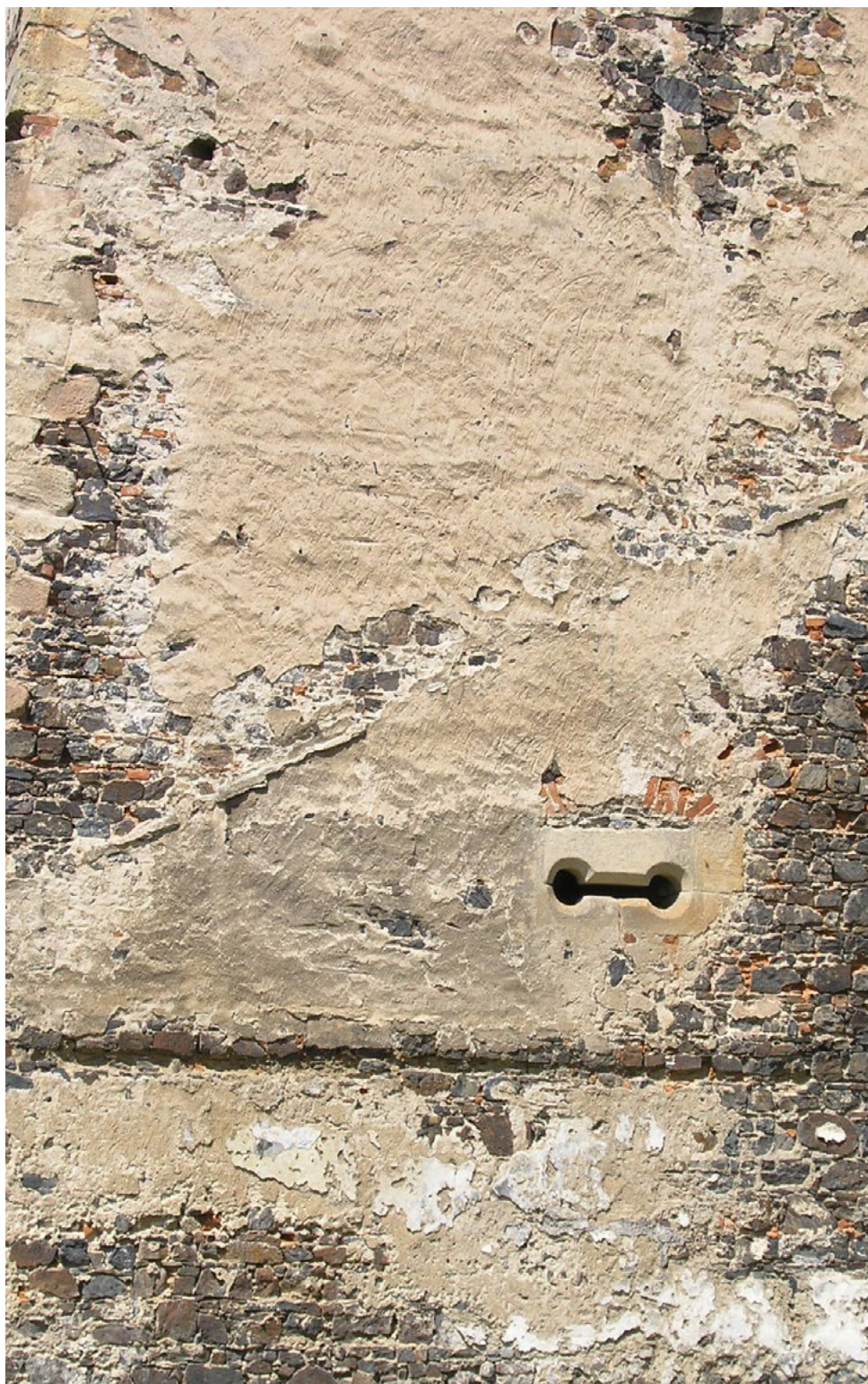
↓ Pozdně středověké vápenné omítky na fasádě věže SH Švihov, stav před konzervací
